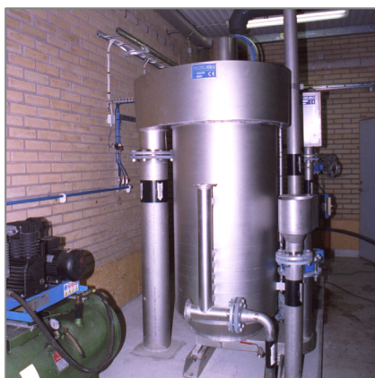
Sandfilter speciellt konstruerade för avloppsvattenrening.
